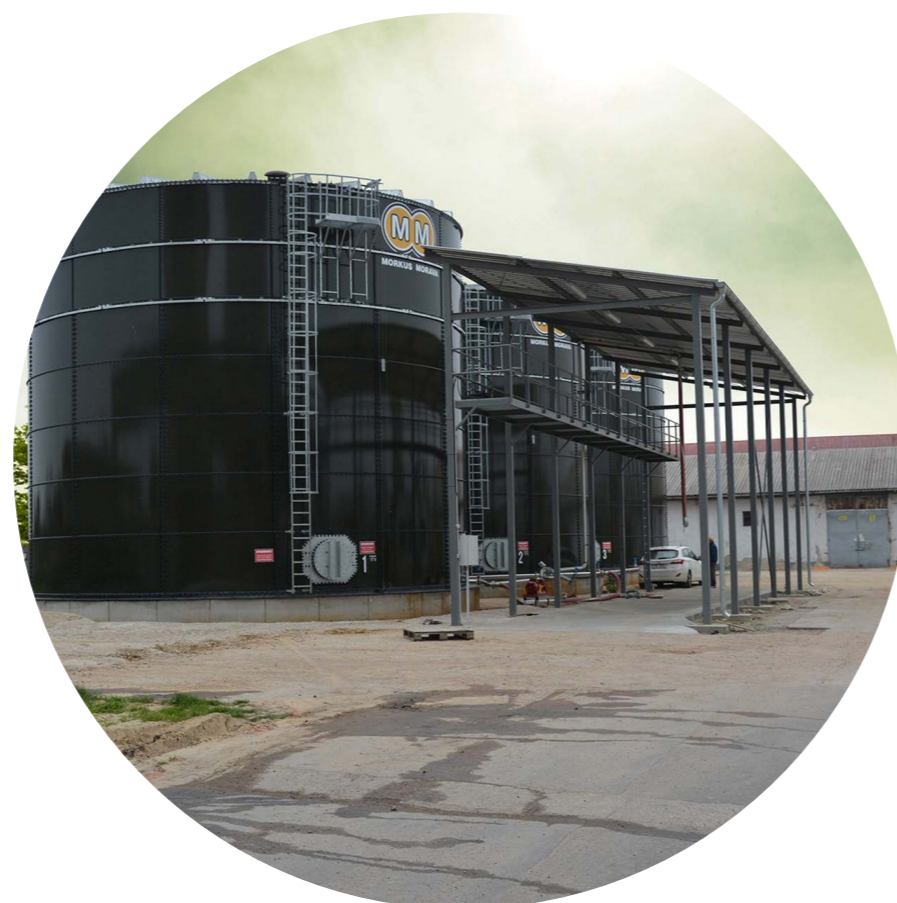
NÁDRŽE NA DAM
